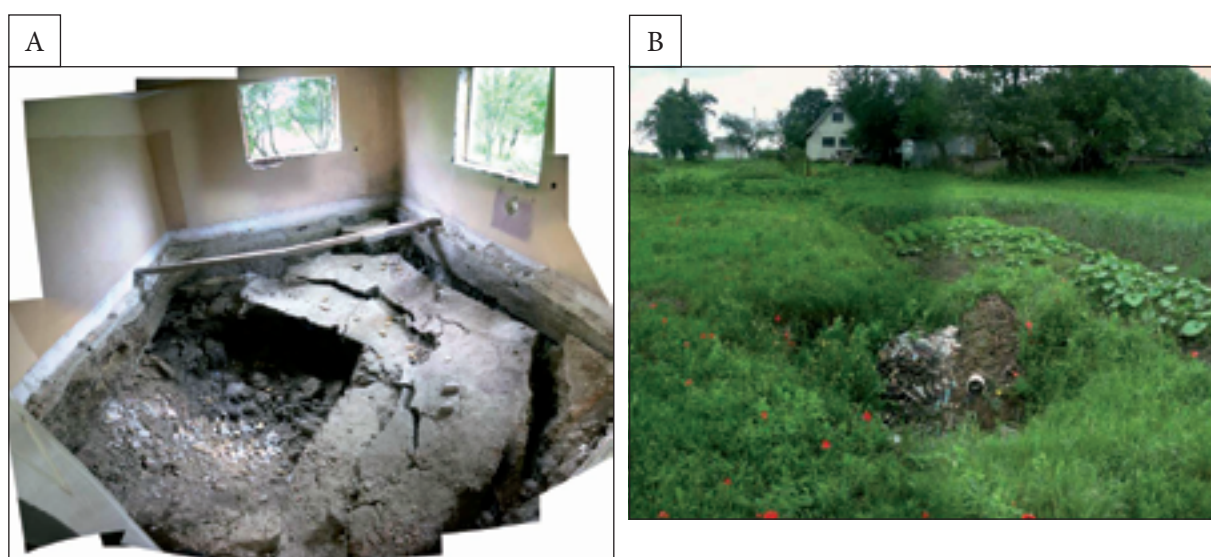
Fig. 6. Karst failures. Borislav
